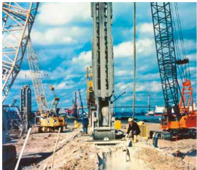
Container Terminal Altenwerder CTA (Hamburg)
